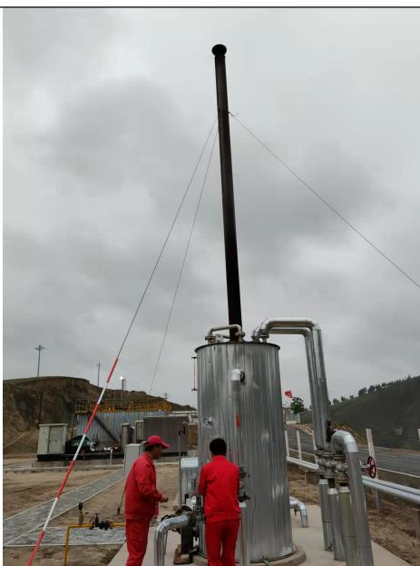
水套炉排气筒
